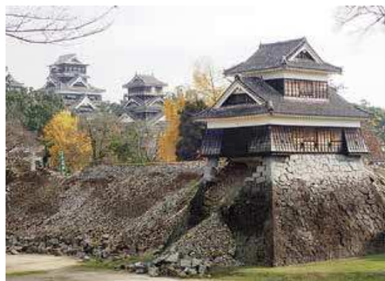
崩壊した熊本城石垣
